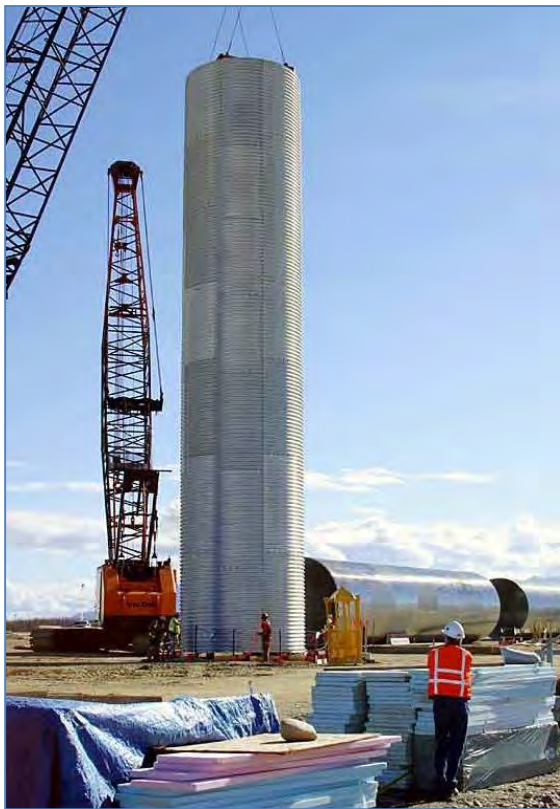
Schéma 107: Un revêtement de silo soulevé pour être installé dans le puits de missile d'un complexe de lancement en construction (The Boeing Company)
